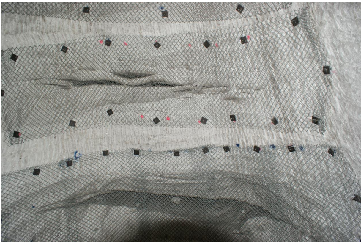
Abbildung 1 – Dehnungsrisse in der Firste oberhalb der Laugenstelle P750006. Aufnahme Krupp, Befahrung vom 14.07.2016.
