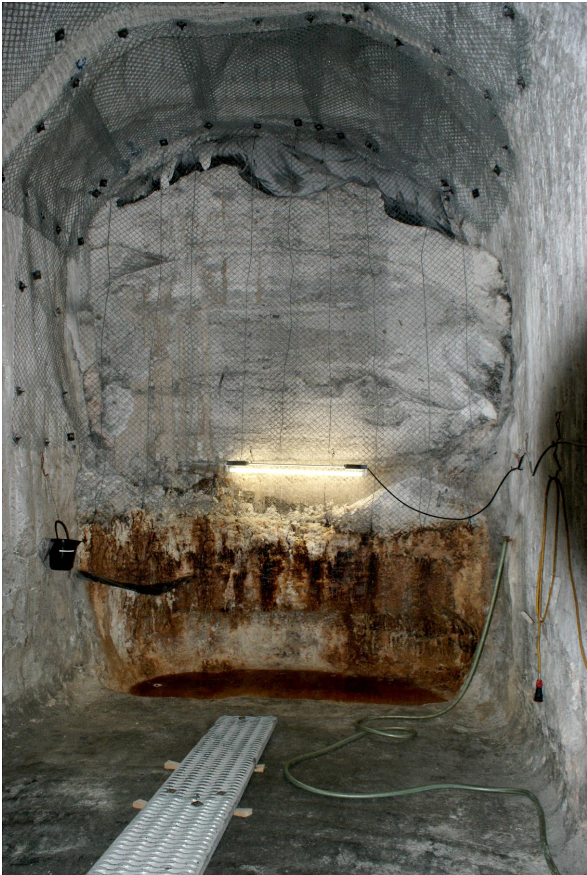
Abbildung 2 - Laugenstelle P750006 im Pfeiler zwischen Abbau 9/750 und ELK 8/750 (Pfeilerreihe 2/3). Durchsickernde aufgestaute Lösungen. Über dem Versatzkörper (hinter der Folie) ist ein unverfüllter Firstspalt erkennbar. Aufnahme Krupp, Befahrung vom 14.07.2016
